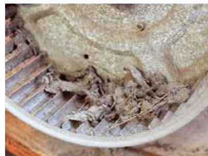
Det bliver til meget snavs, der bliver frigjort fra blæserhjulet. Mængden er afhængig af, hvor blæsere har været brugt og hvor længe den har kørt.
