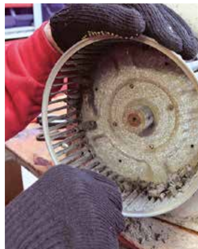
Det kræver tålmodighed at rense blæserhjulene, da "skidtet" sidder fast og er hårdt som beton. Det stopper ribberne i blæserhjulet og kan derfor ikke tilføre hoppeborgen den luft, der skal til for at den står struk.
